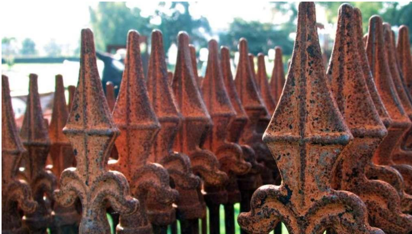
pl. vasfelület korróziója levegőn
